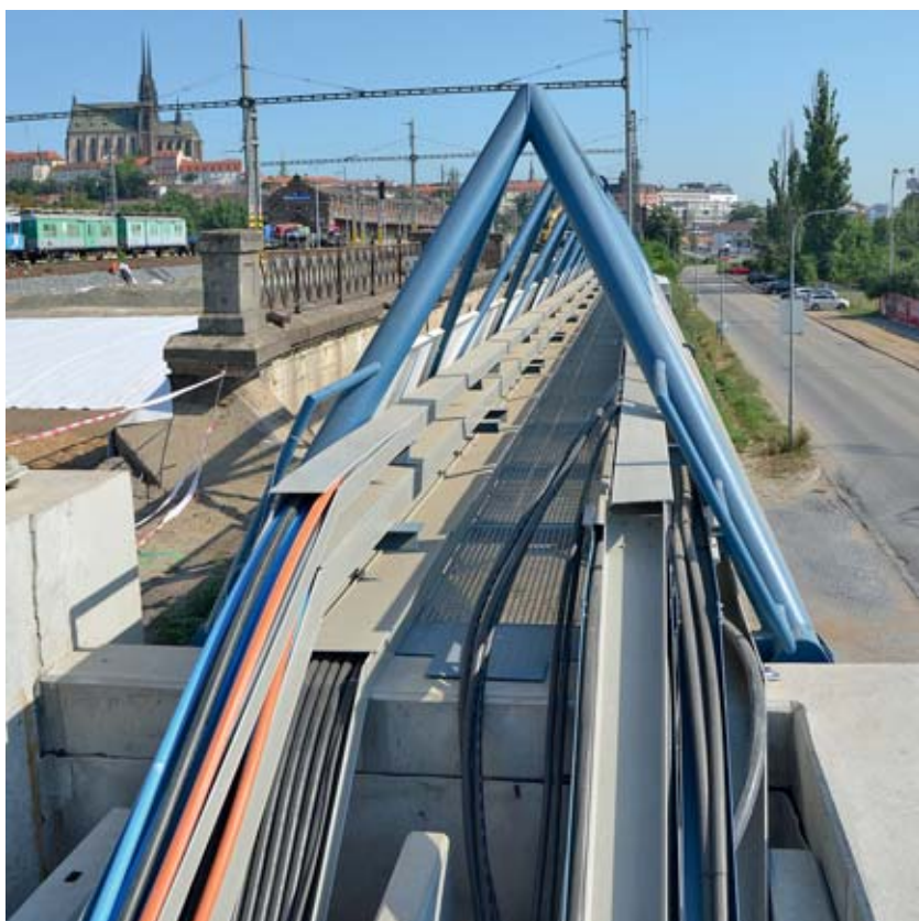
KABELOVÉ BOXY – BRNO, UHELNÁ
