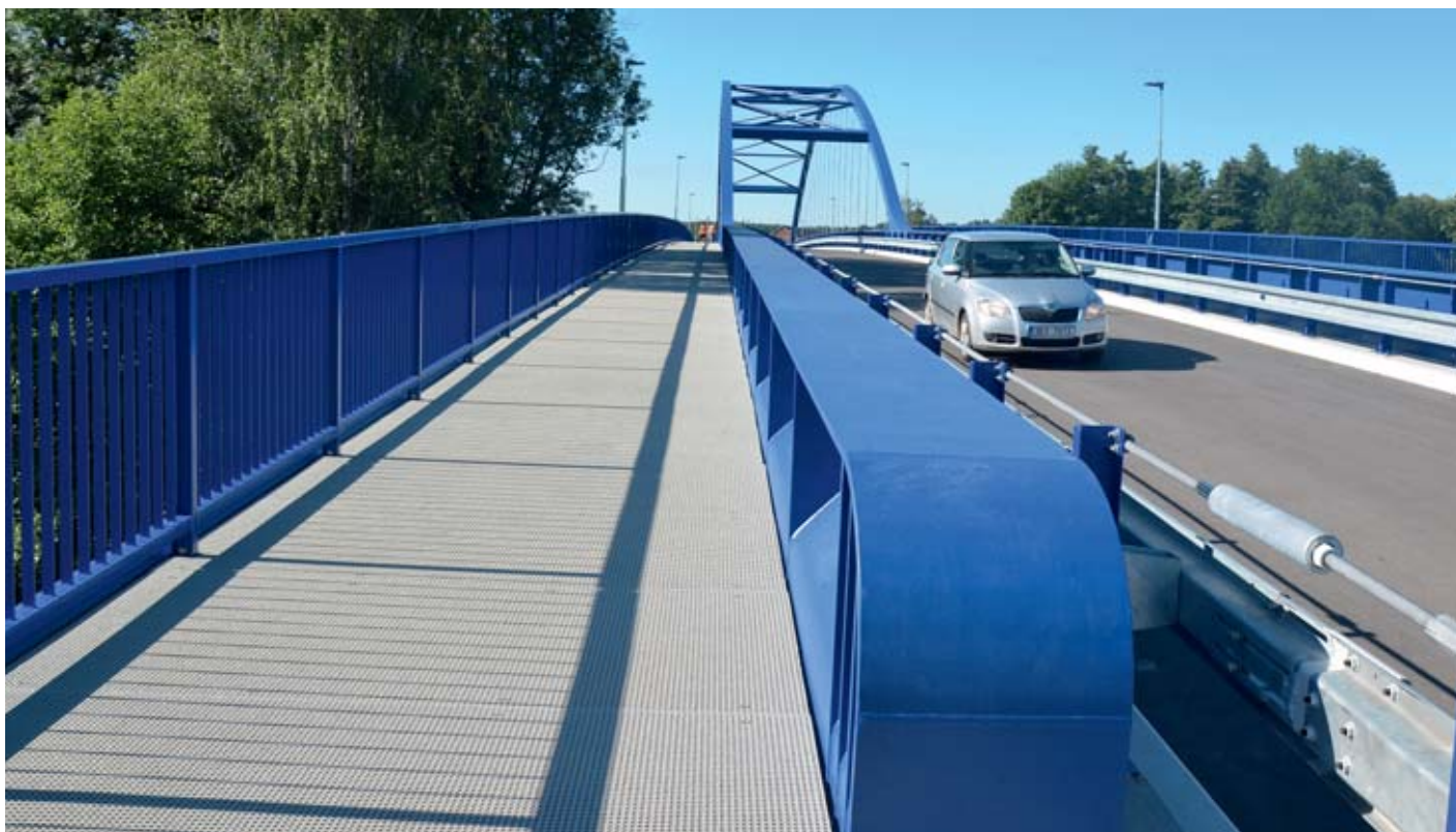
LITÉ ROŠTY NA CHODNÍCÍCH – MOST VALY-MĚLICE
