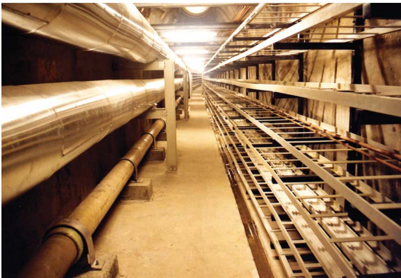
KABELOVÉ LÁVKY A NOSIČE – OSTRAVA, KOLEKTOR CENTRUM
