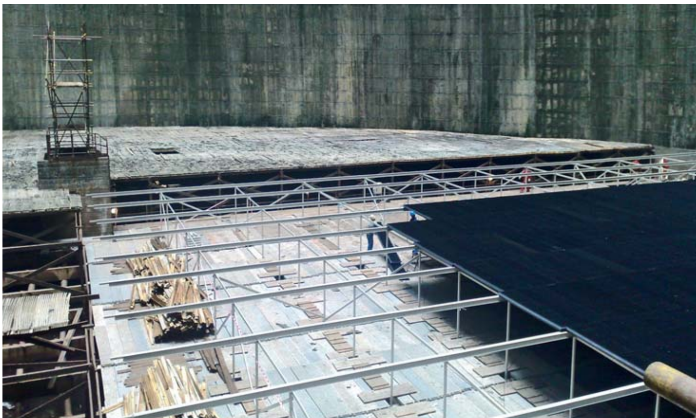
KONSTRUKCE PRO ELIMINÁTORY – JADERNÁ ELEKTRÁRNA DUKOVANY
